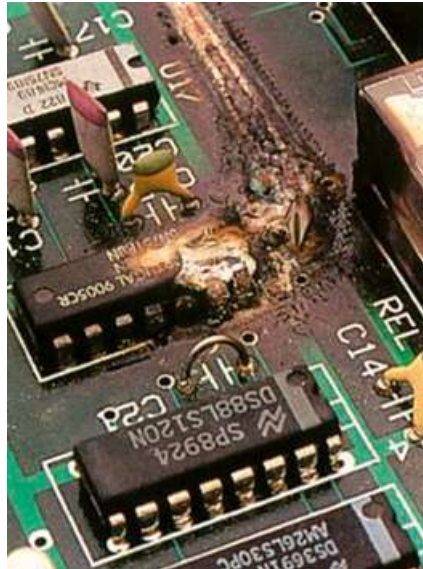
Danni da sovratensioni in un server
