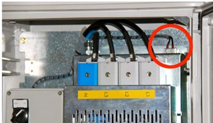
Foto di un installazione e di un particolare degli SPD tipo ILF 4P 250 e 400
